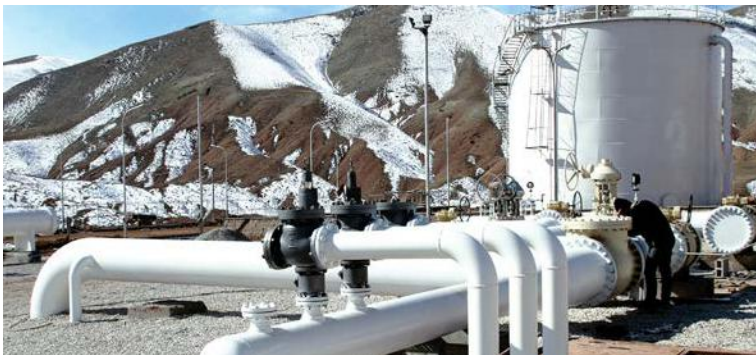
مشروع مضخة و منشآت خط نقل النفط الخام تكا-رى (منجز)
