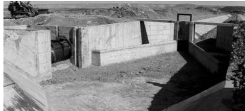
مصفاة الرى - الشبكة D1 فومنات
