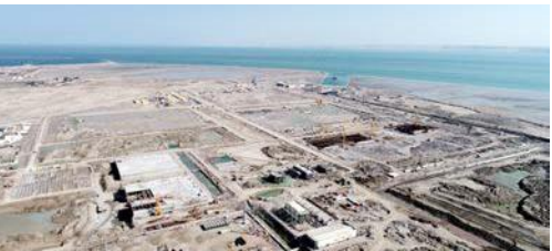
تحلية المياه ٢٠٠ الف متر مكعبا
